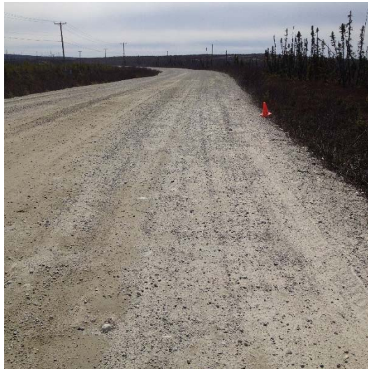
Photo 1 : Secteur très mou entre courbes 5+250 chaussée
