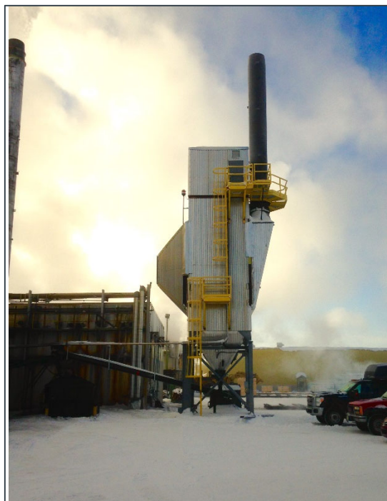
Figure 1 : Précipitateur électrostatique sur l'ancienne usine
